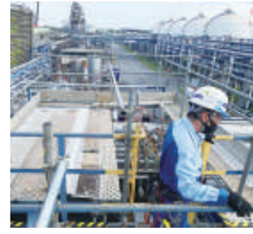
工事内容をはあくし、現場の安全、工程、品質などの管理をします。また、作業者に指示を出します。
