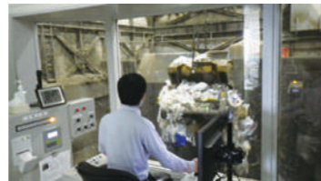
ごみクレーンでピットから廃棄物を挿んで焼却炉に投入
